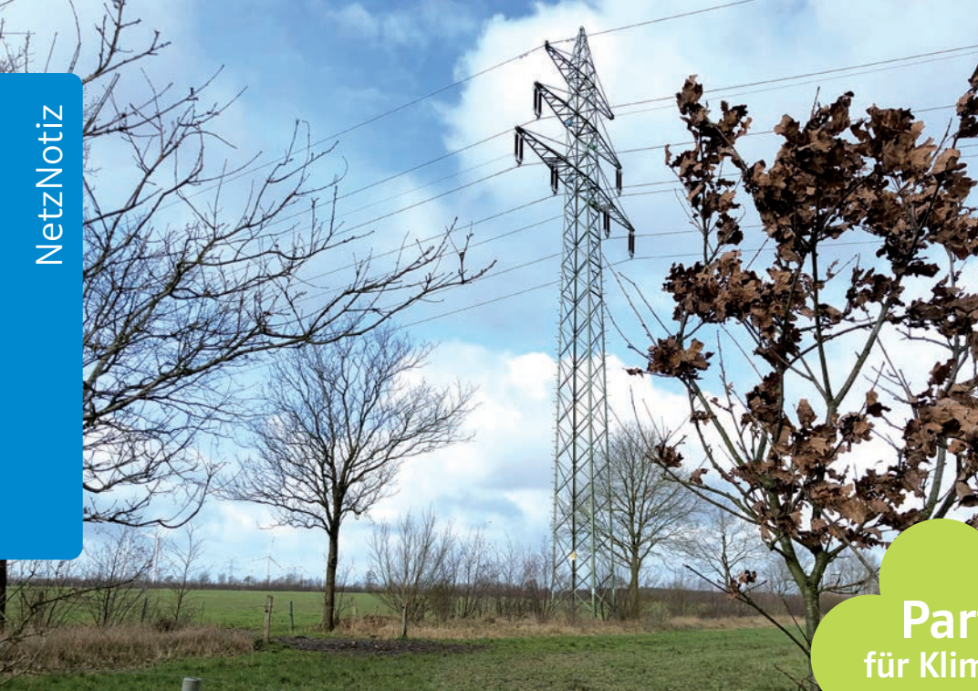
110-kV-Leitung Flensburg-Weding im Herbst
