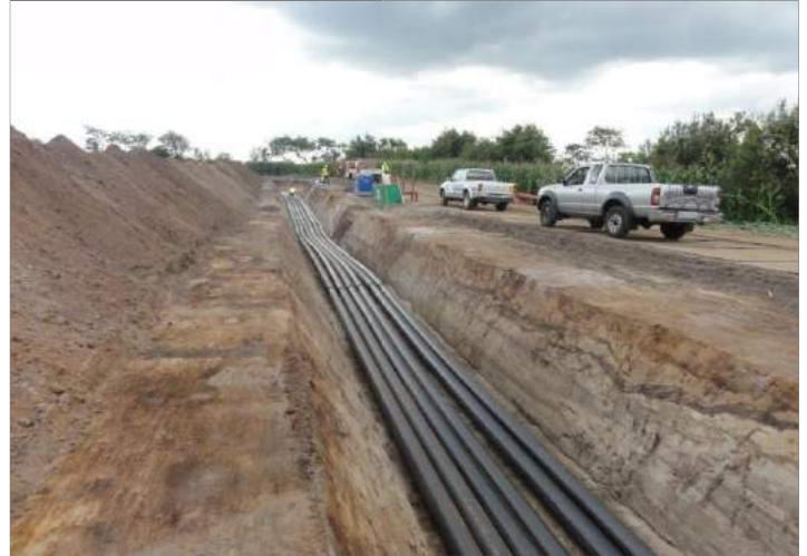
Links im Bild lagert der Unterboden, in der Mitte ruhen die Leerrohre im Kabelgraben und rechts neben der Grube befindet sich die Baustraße.
