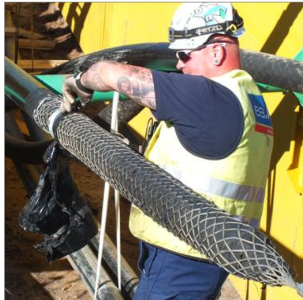
Endlich angekommen: Am anderen Ende des Leerrohrs wird das Kabel von dem Kabelstrumpf befreit.
